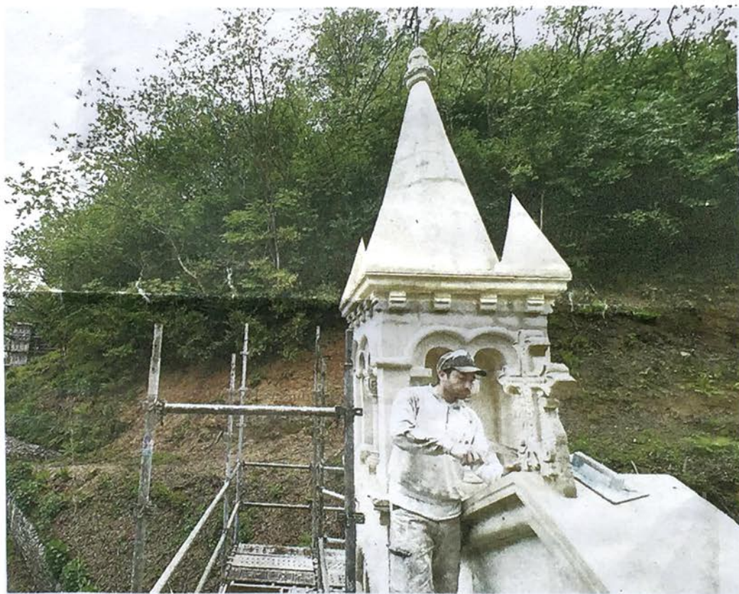
L'entreprise bayonnaise Arrebat restaure, en ce moment, les pierres de taille et la maçonnerie des premiers oratoires. / Photo Laurent Dard.
